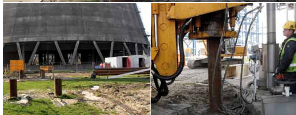
Buizen van De Boer Staal doen dienst als fundering van de nieuwe energiecentrale Moerdijk 2.
